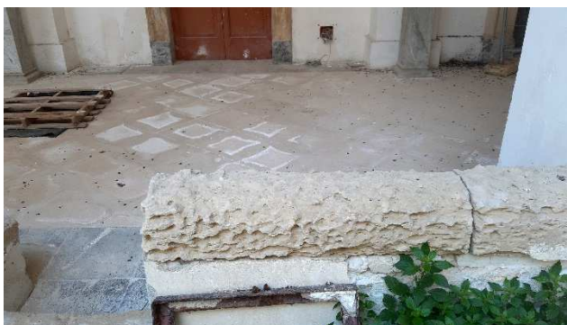
Foto 16 – Degrado pietra leccese
