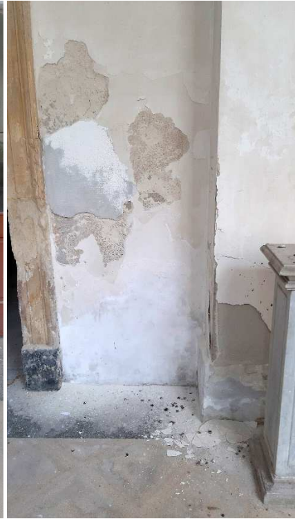
Foto 09 – Degrado intonaci per umidità di risalita
