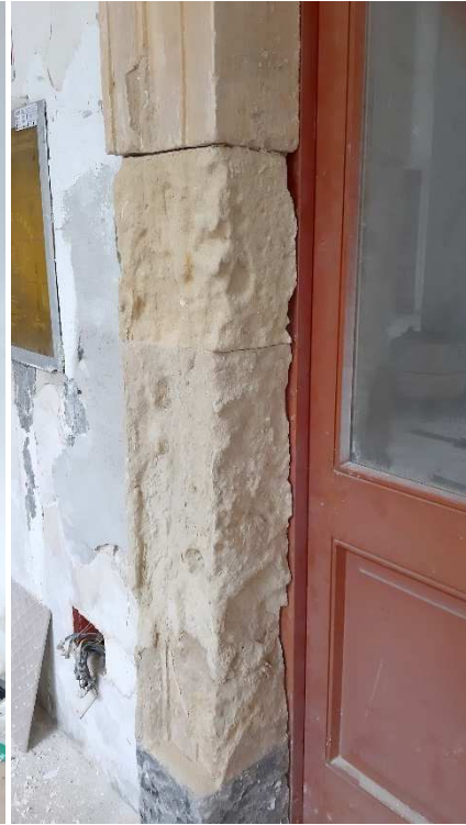
Foto 20 – Degrado pietra leccese
