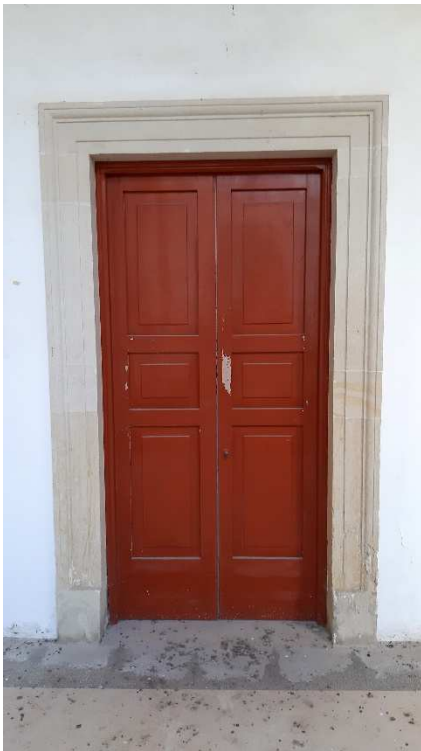
Foto 22 – Infisso da sostituire
