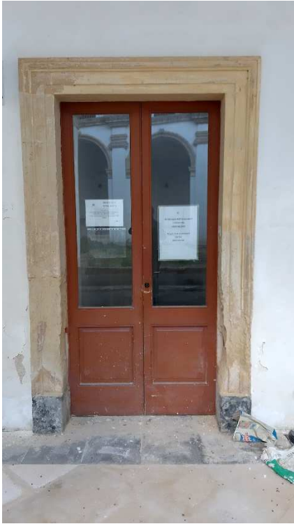
Foto 19 – Infisso da sostituire
