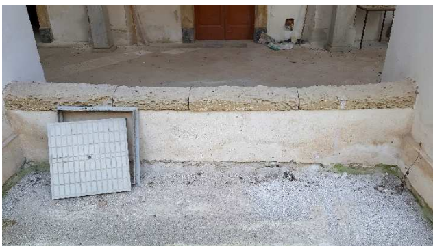
Foto 17 – Degrado pietra leccese
