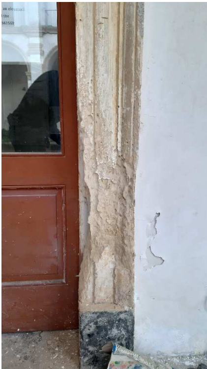
Foto 10 – Degrado pietra leccese
